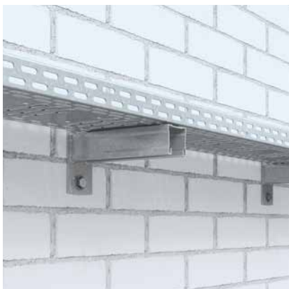
Chemins de câbles
